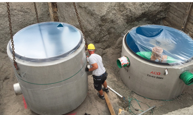
Parkplatz West Merck, Gernsheim
