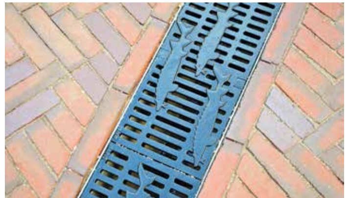
(Quelle: ACO Tiefbau, Büdelsdorf)
