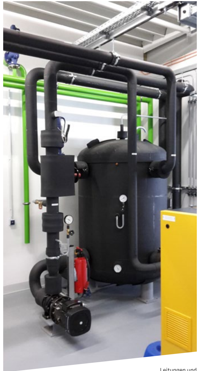
Leitungen und Vorhaltebehälter der Kälteanlage Haus F. (Bild: Max Straube Industrierohrleitungsbau GmbH)
